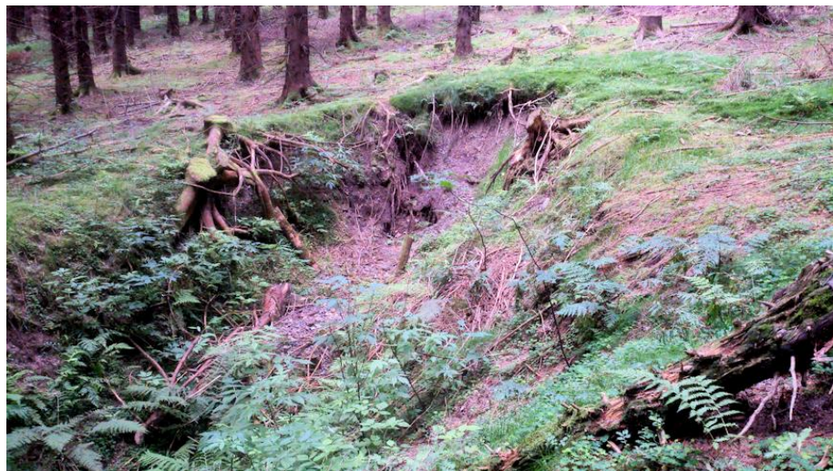
Zabořené ústí štoly Concordia (foto: Michal Urban)
